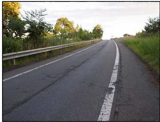
舗装損傷写真
