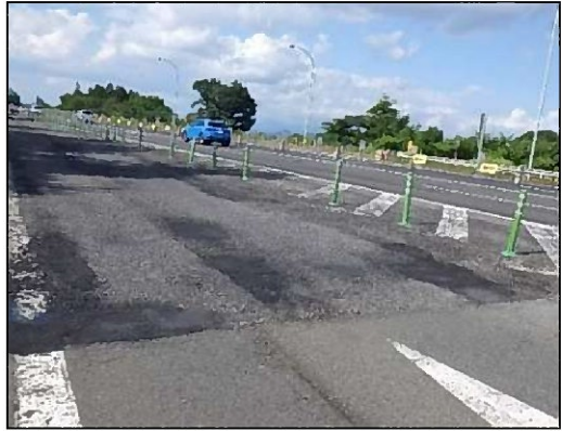
舗装損傷写真
